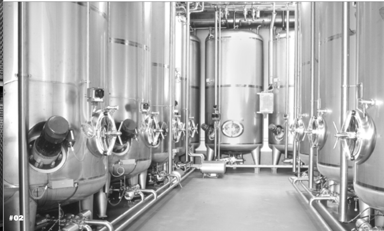
#01 Wein-Tanks #02 Pharma-Behälter #03 Saft-Ausmisch-Behälter #04 Spirituosen-Tanks
