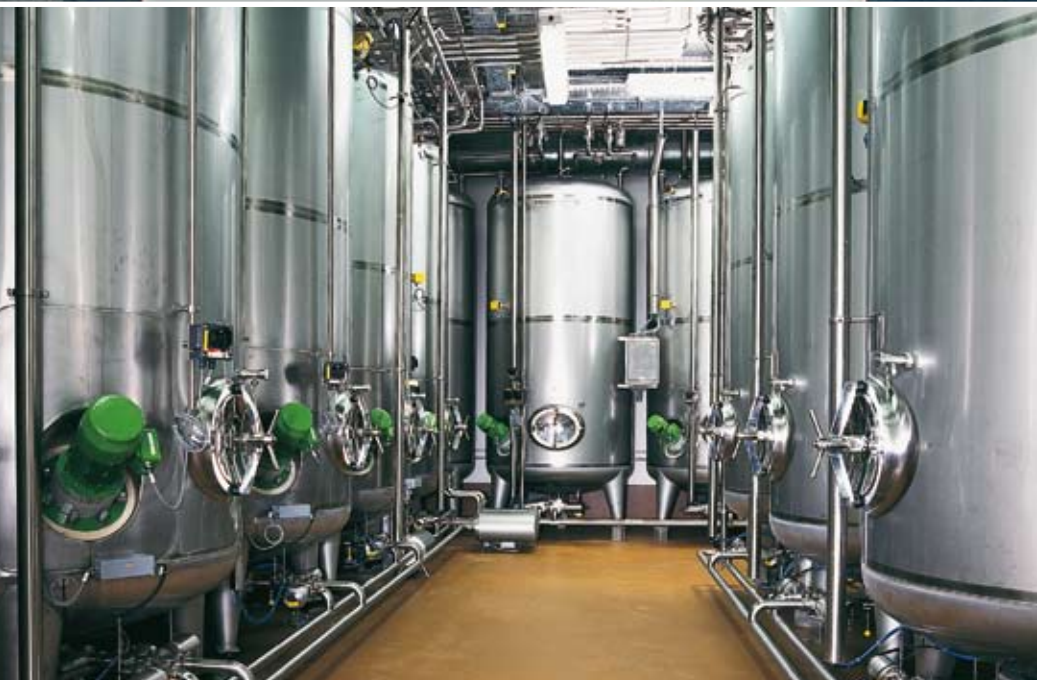
Citernes de conservation pour préparations pharmaceutiques Max Zeller Söhne AG Romanshorn, Suisse
